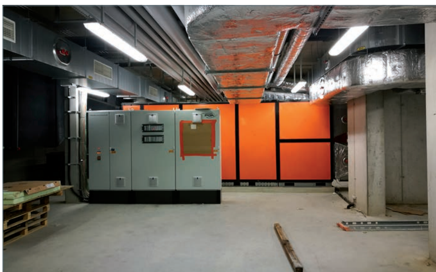
■ Der Schaltschrank mit der Mess- und Regeltechnik, Foto: 4a Architekten GmbH, Stuttgart
