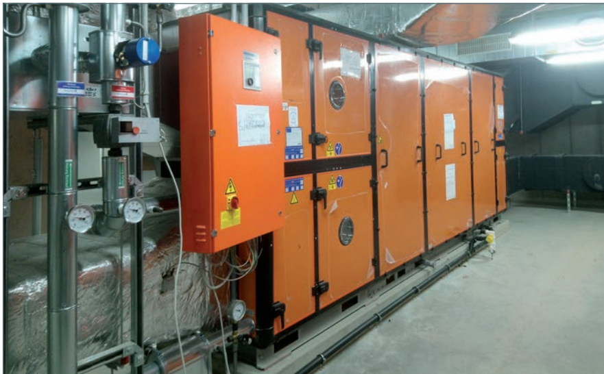
■ Die Raumlufttechnik der Schwimmhalle, Foto: 4a Architekten GmbH, Stuttgart
