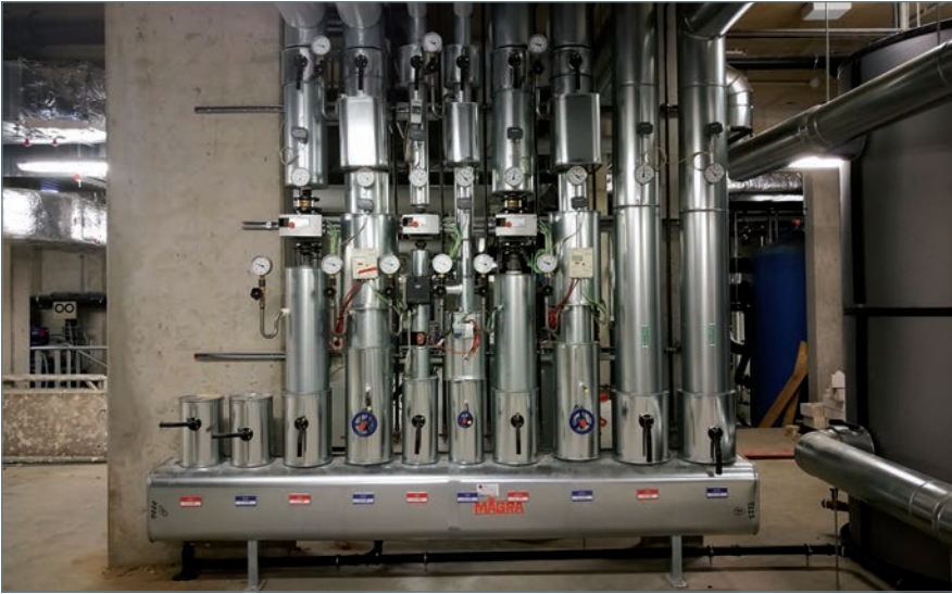
■ Blick auf den Heizungsverteiler, Foto: 4a Architekten GmbH, Stuttgart
