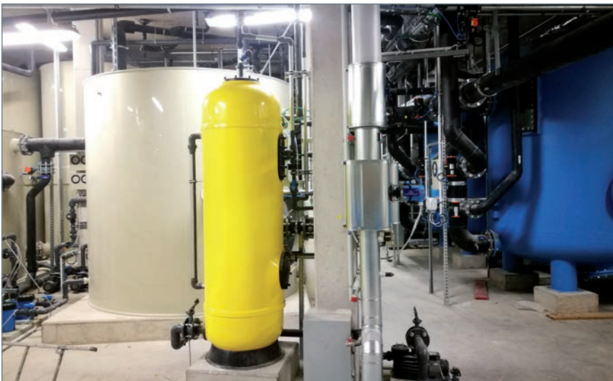
■ Die Technikzentrale „Badewasser“ mit Filtern und Spülabwasserspeicher ...
